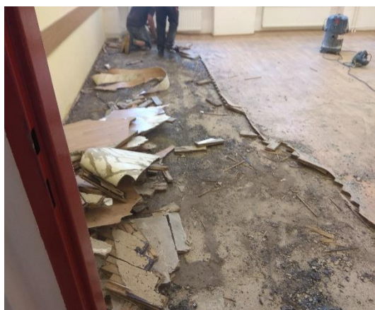
Poškozená podlaha v učebně
